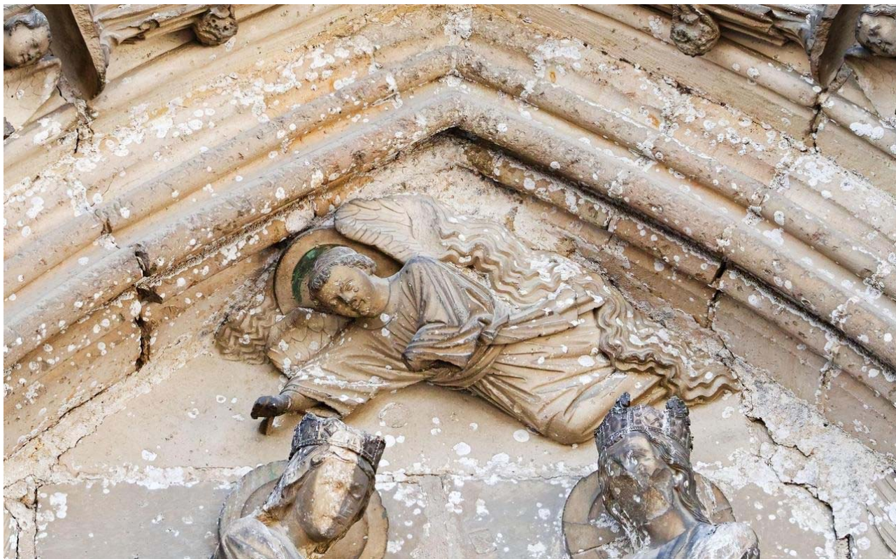
Certaines sculptures sont en mauvais état./Daniele Rocco photographe
